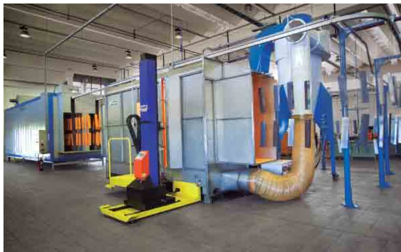
Centro de pintura eletrostática
